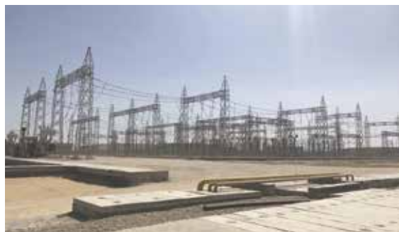
پست برق پروژه در بهره برداری
